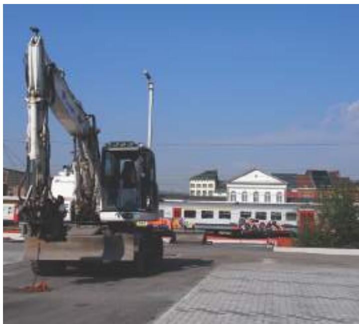
Les nouveaux parkings, à l'arrière de la gare, d'une capacité de 470 places.
