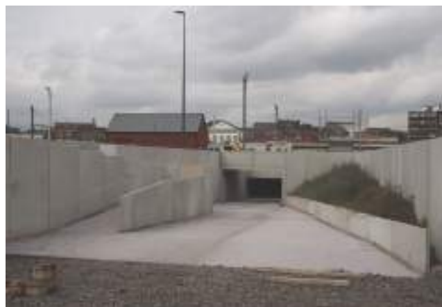
Prolongation du tunnel sous-voie et rampe d'accès piétonne vers l'arrière de la gare et le nouveau parking.
