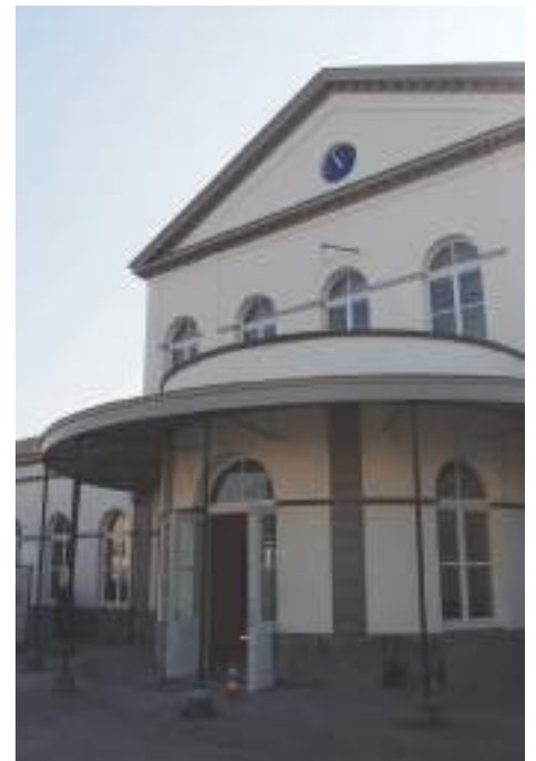
Les façades ont été entièrement rénovées : maçonneries, pierres de taille, boiseries et peintures.
