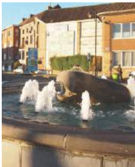
Réparation et remise en fonction de la fontaine de la baleine, en face de la gare.
